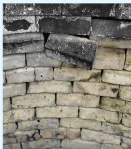
굴뚝 내부 파손 탐지
